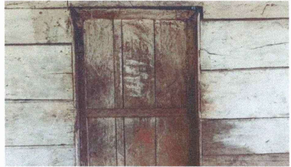
Foto 4: Puerta de cocina de la escuela necesita sustitución.
